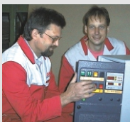
Programmierung eines ÖKOTHERM-Energiespeichers.
